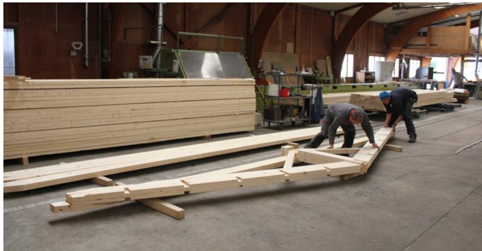
Les maisons en ossature bois sont préconstruites en usine avant puis assemblées sur place.
